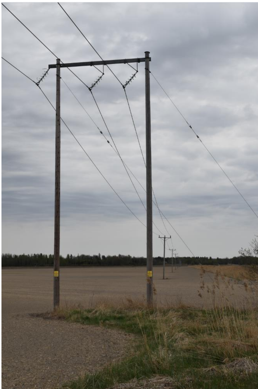
Figur 6. Kraftledning i ost-västlig riktning. Vattenfall ansöker om att radera ledningen och ersätta med en ny sträckning.
