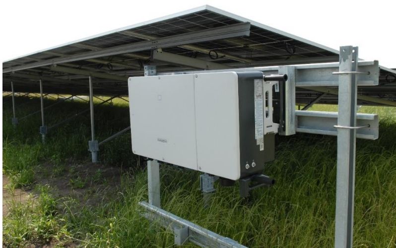
Figur 9. Växeloriktare monterad vid solcellspaneler (LC Energi, Platsbesök solpark Holland, 2023).
