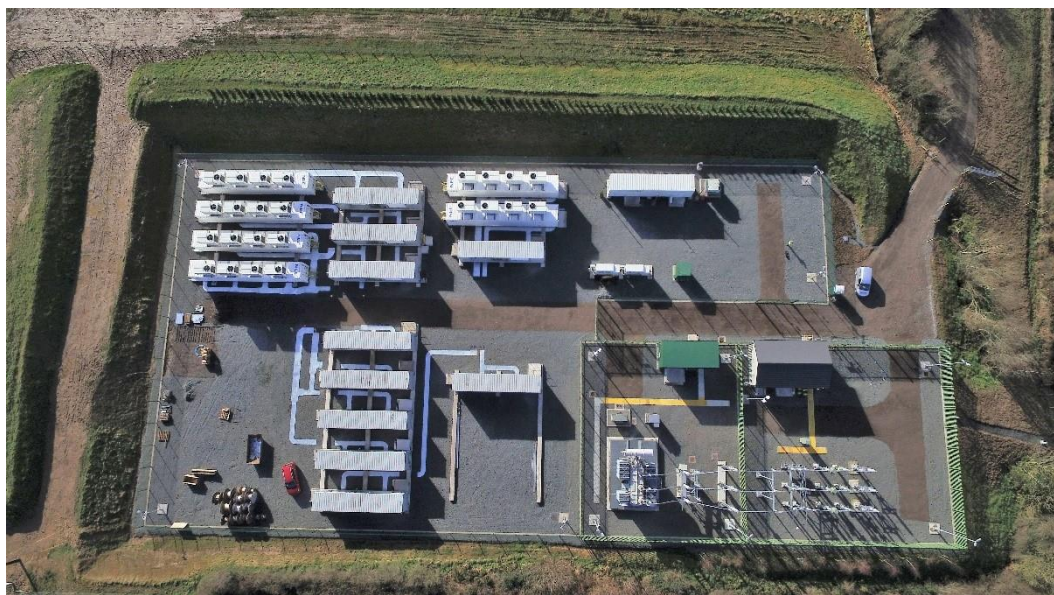
Figur 12 Exempel på batterilager (LC Energi)
