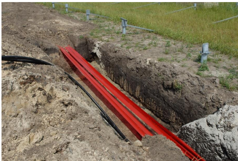
Figur 11. Kabelschakt för mellanspänningskablar (LC Energi, Platsbesök solpark Holland, 2023).
