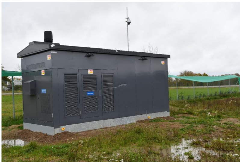
Figur 10. Exempel på en transformator. (LC Energi, Platsbesök Forsby Solpark, 2023).
