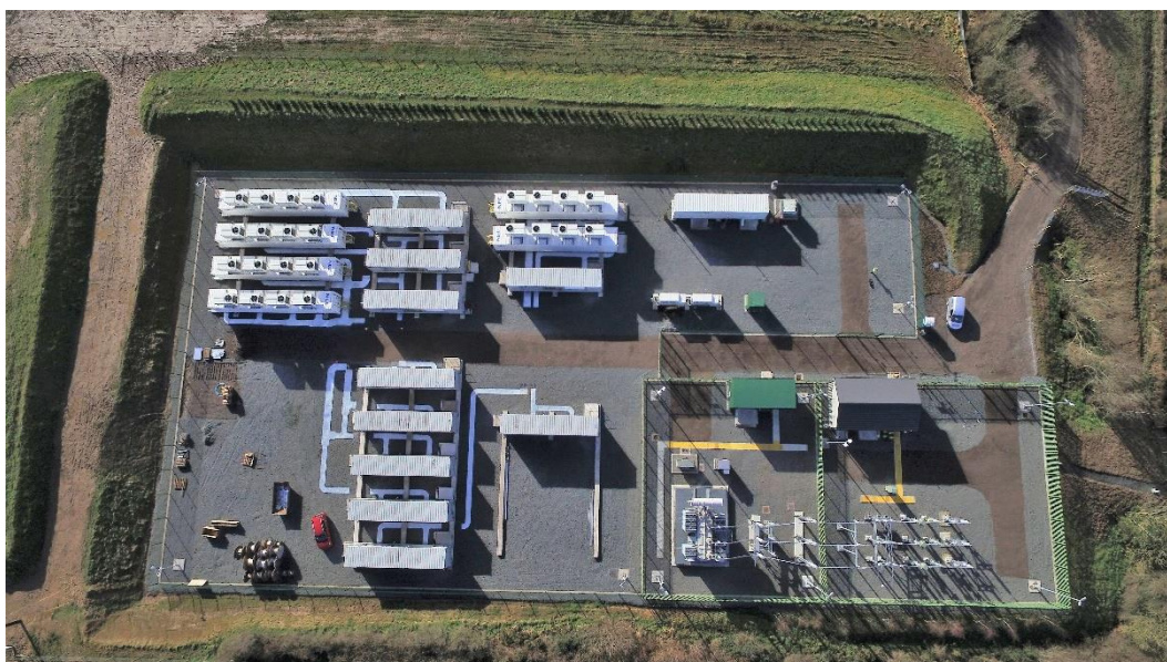
Figur 12 Exempel på batterilager (LC Energi)
