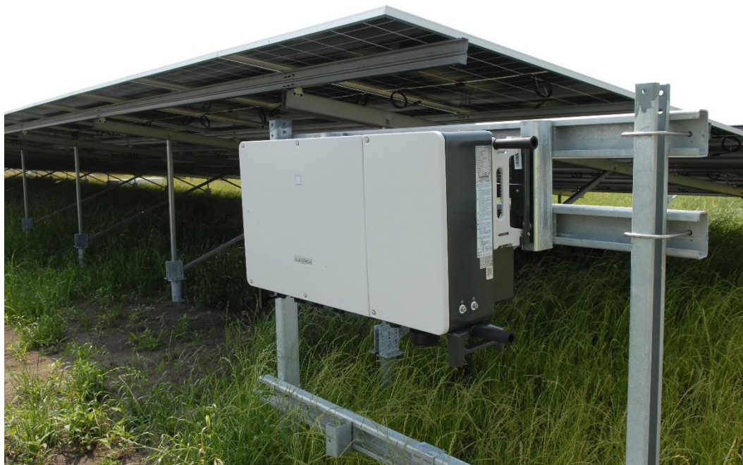
Figur 9. Växelriktare monterad vid solcellspaneler (LC Energi, Platsbesök solpark Holland, 2023).
